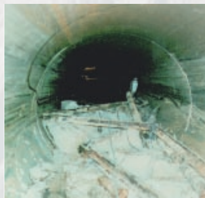
Ein Blick durch das vorgetriebene Stahl- rohr. Deutlich zu erkennen sind Teile der kreuzenden Schienenanlage, die zerstört und in das Rohr verdrängt wurden.
