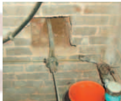
Freigelegte Bleileitung im Keller eines Gebäudes.
